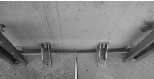
Projekt: Linz AG Center, Linz Beschreibung: Einbau Brüstungsanker und Verblendkonsolen Foto © Dyckerhoff & Widmann, Linz
